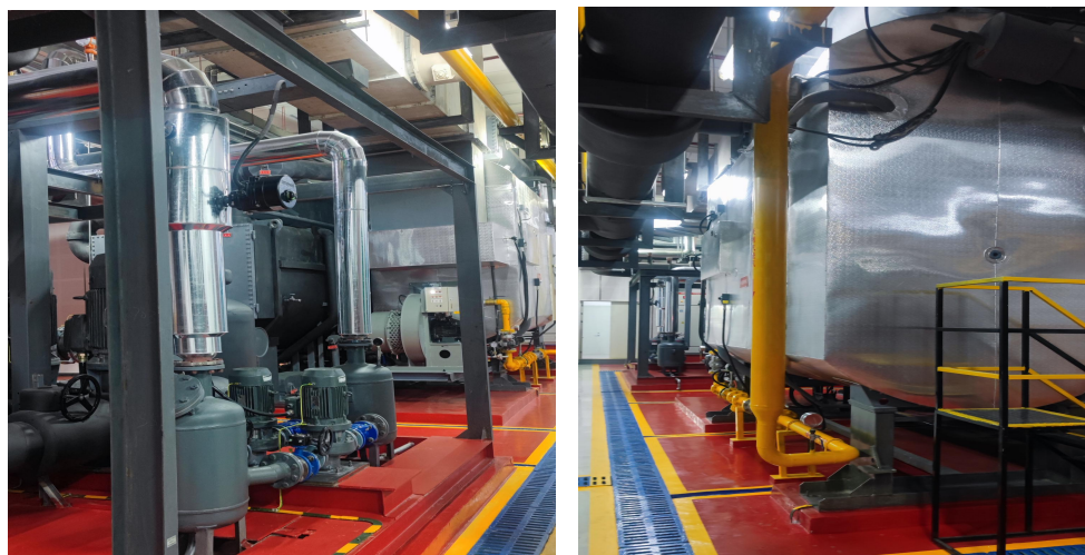
图8 直燃机组照片
